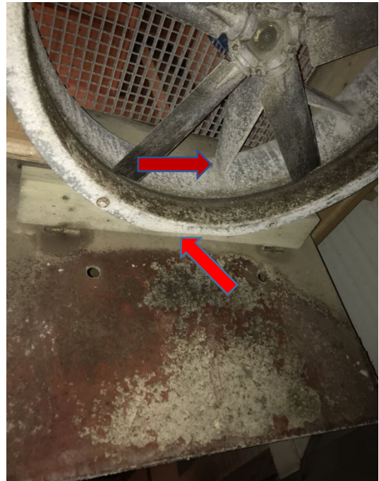
Figure 3 - Conduite souterraine avec matériaux meubles et dépôts de CIPC.
